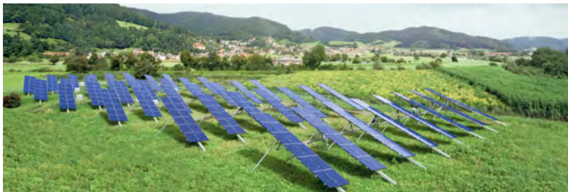
Rheinau 生產基地。28 台跟蹤式 SunCarrier 22 光伏發電設備，占地少，易於安裝，每年可發電 135,000 千瓦時。
